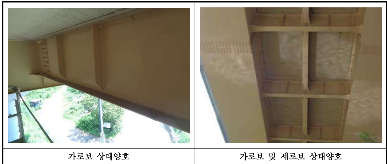
【사진 4.3.7】 가로보 및 세로보 손상현황
