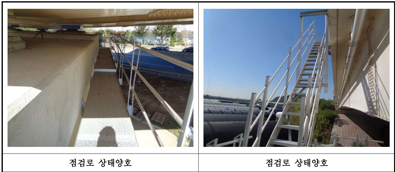
【사진 4.3.26】 교량 점검시설 손상현황
